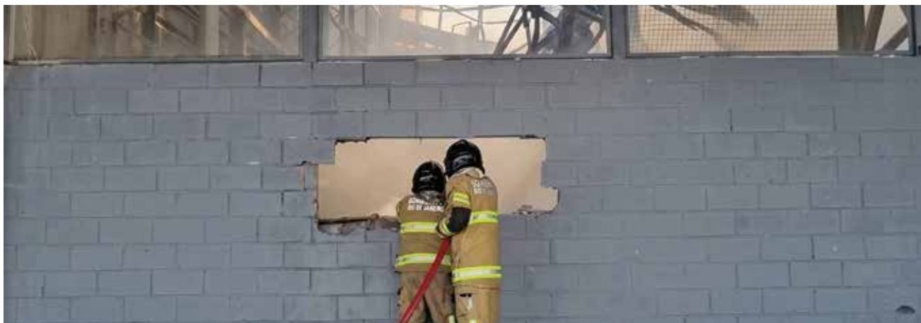
Figura 53 - Incêndio em galpão localizado no Aeroporto Internacional do Galeão, no Rio de Janeiro.
